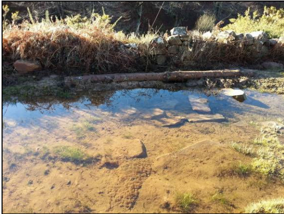
Foto Dique 1: corresponde con el punto de desagüe principal del humedal. Supone el encharcamiento de un tramo de pista de 150m 2 .
