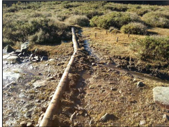
Foto Dique 2: derivación del agua procedente de la pista mediante rollizos de madera a una zona llana, de 500m 2 , con gran potencialidad para el desarrollo de vegetación de turbera. Se puede observar la parcela de seguimiento de vegetación.
