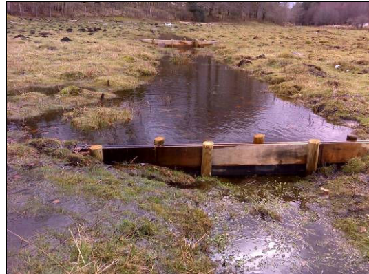
Foto: diques n° 3 y 4. Se observa el efecto de la estructura que por un lado embalsa el agua y por otro favorece el encharcamiento de las zonas aledañas.
